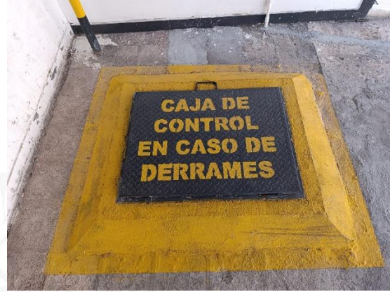
Cajilla de inspección de control en caso de derrames.
