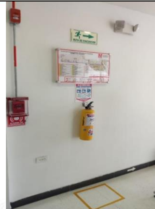
Sistema de alarma de emergencias
