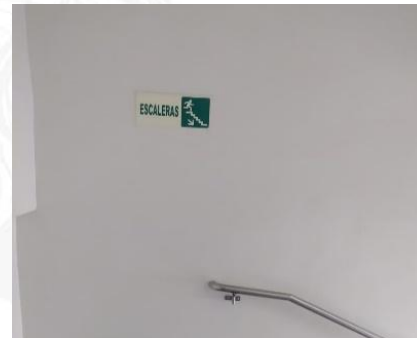
Señalización de escaleras y pasamanos de seguridad en escaleras
