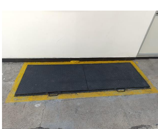
Cajilla de inspección de aguas
