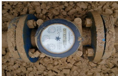
Ilustración 2 Medidor del pozo Ciudad Universitaria
